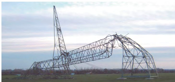
Abb. 12: Umgeknickter Strommast, Foto: www.wikimedia.org (Abruf: August 2019).
