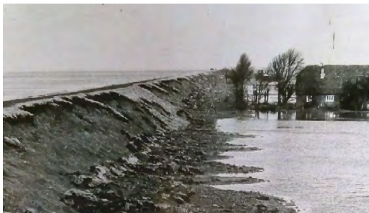
Abb. 2: Rutschungen der Binnenböschung an einem Deich in der Wesermarsch, Quelle: FSK (1962).
