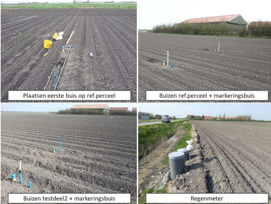
Figuur 4.8 Installatie van de peilbuizen op 2 mei 2013. De regelputten zijn zichtbaar en regenmeter zijn zichtbaar op de foto rechtsonder.
