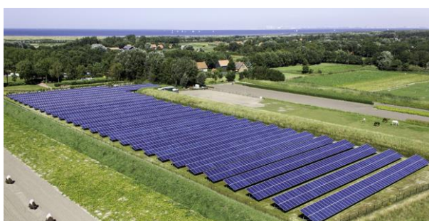
Zonnepark van 1,3 hectare (0,85 KWp). Locatie: Goeree Zonnepark Ouddorp aan Zee.
